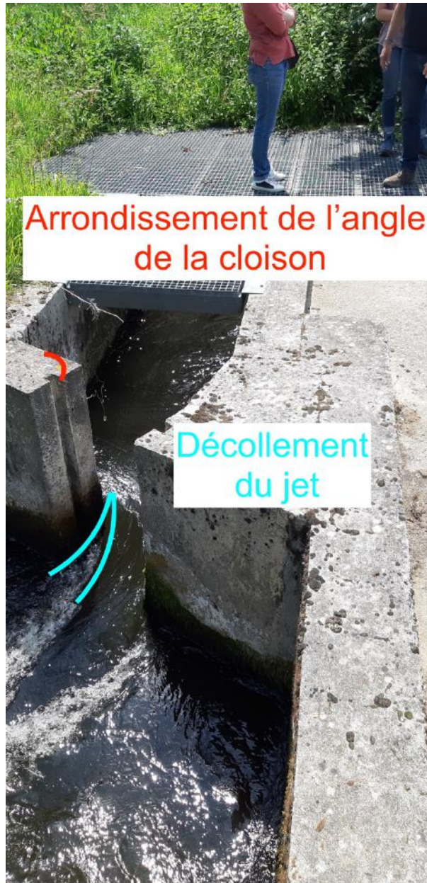
Figure 10 : écoulement passe à poissons rive droite
